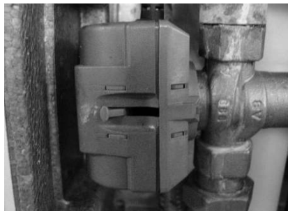
Aspiration eau de pluie dans cuve de récupération EP
