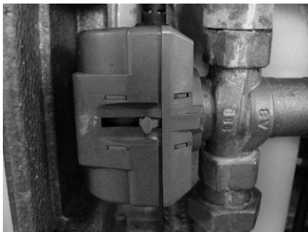
Aspirazione acqua di rete tramite il disconnettore.
