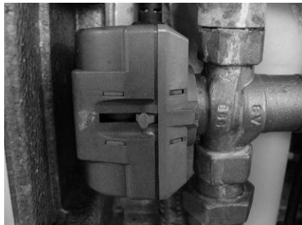
Aspiración de agua de red mediante válvula antirreflujo
