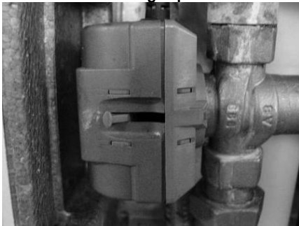
Aanzuiging van regenwater in het opvangreservoir EP
