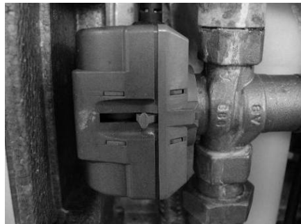
Ansaugen aus Leitungswassertank mittels Systemtrenner
