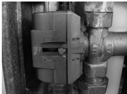
Aspiration eau de ville dans le disconnecteur
